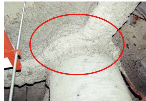
付着した綿状の物質が吹付け石綿 出典 国土交通省 目で見えるアスベスト建材
