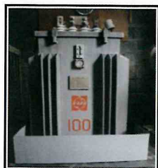
高圧トランス
